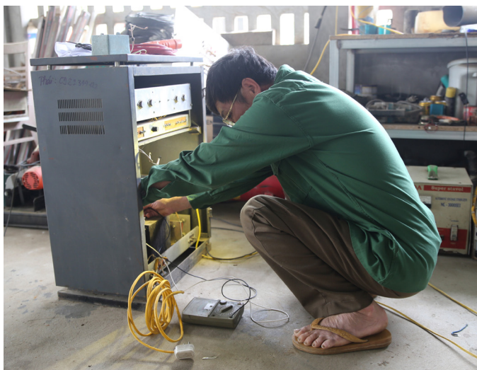
Ông Nguyễn Đức Hồng tự sửa chữa mỗi khi hệ thống truyền thanh xã gặp sự cố
